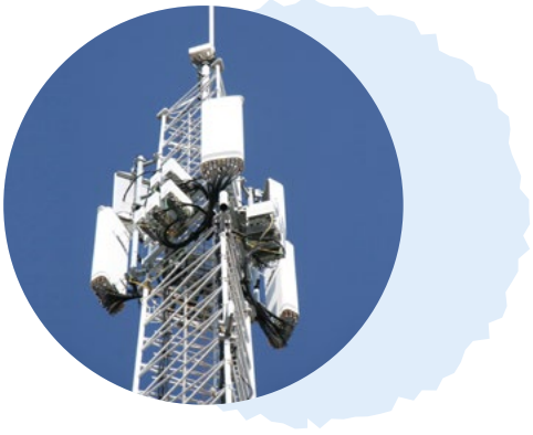
Mobilfunkmast mit drei Sektorantennen für 360° Mobilfunk-Abdeckung. ©diagnose:funk
