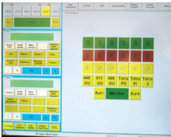
Feststation auf der Wache, einmal mit analogem Funk und zusätzlich ausgerüstet mit TETRA für den ePB – umschaltbar vom eigenen Dienststellenbereich auf Direktionsbereich usw.
